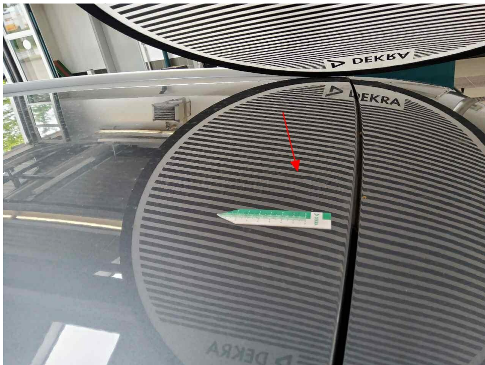
Bild 22 : Dach mehrfach eingedellt
