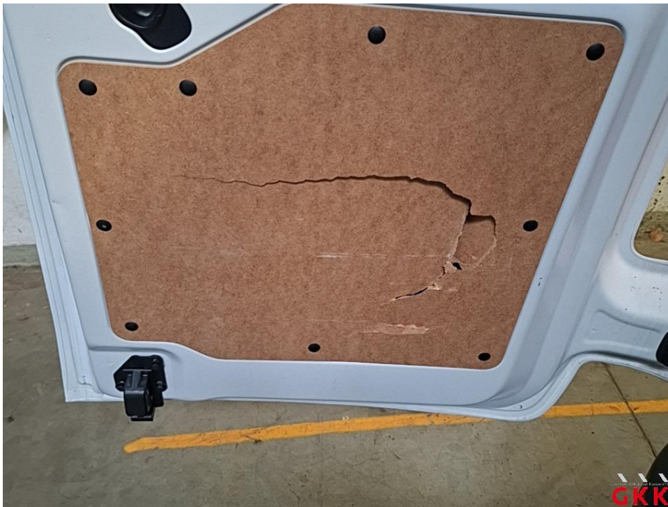
Bild 16 Hecktür links, Innenverkleidung, beschädigt, ersetzen
