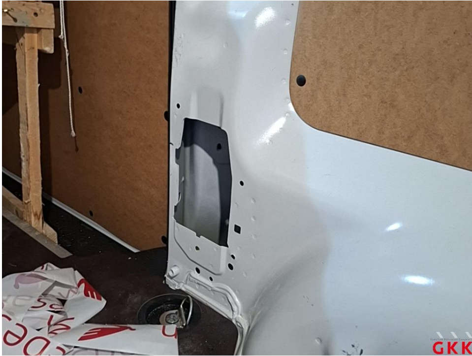
Bild 15 Laderaum, Abdeckung, fehlt, ersetzen
