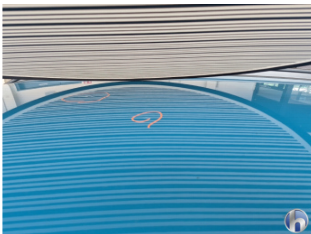
1. Dach 3 Dellen - Sanft Instandsetzen
