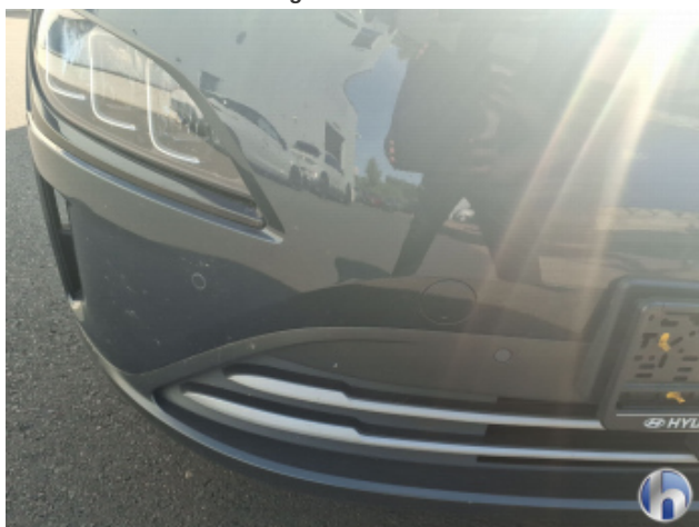
5. Stoßfänger Vorne Gebrauchsspuren - Ohne Reparatur
