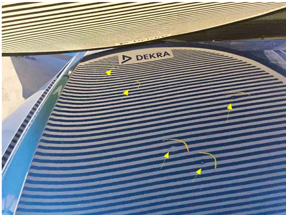
Bild 26 : Aktueller Hagelschaden, MH 16, Dach
