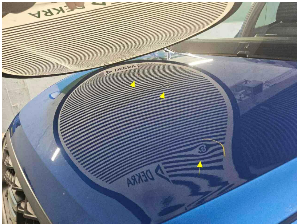
Bild 27 : Aktueller Hagelschaden, MH 16, Dach
