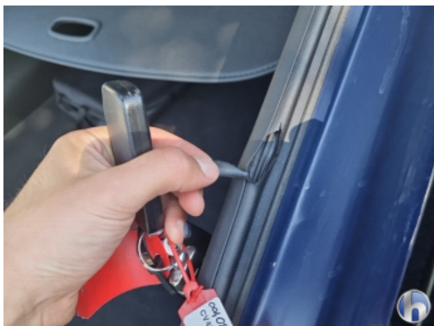
2. Heckklappendichtung Riss - Erneuern
