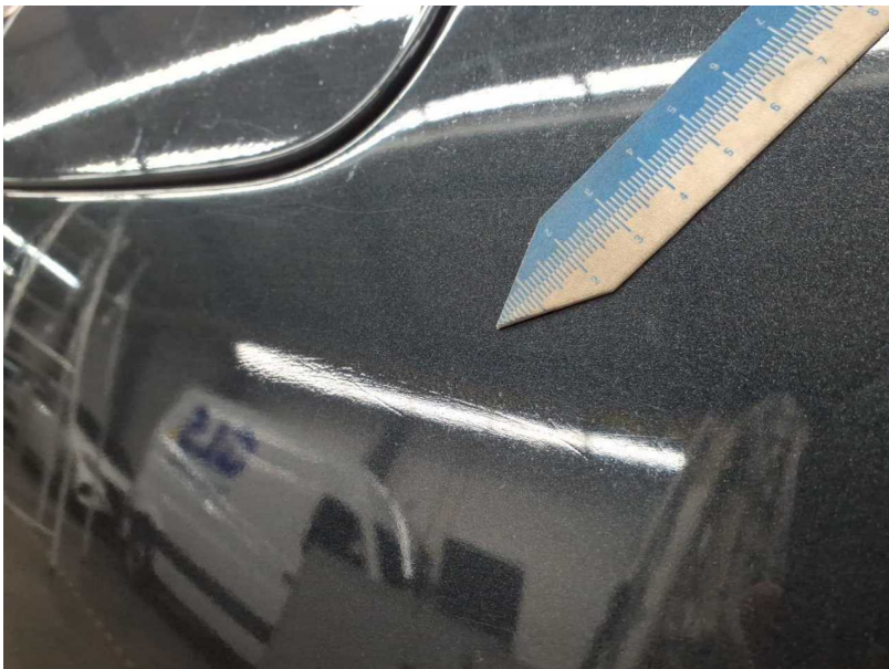
Beschädigung #23: Seitenwand rechts: Seitenwand (Schleifspuren + Lackeinschlüsse + Einätzungen) - nicht fachgerecht instandgesetzt - instandsetzen und lackieren
