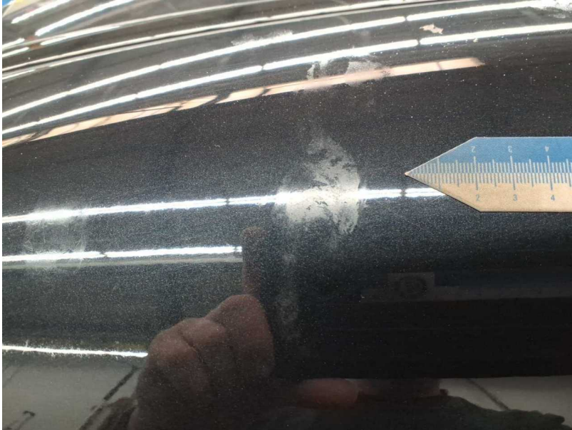
Beschädigung #14: Fahrzeugdach: Dachholm rechts (Einätzungen) - Lackmangel - lackieren
