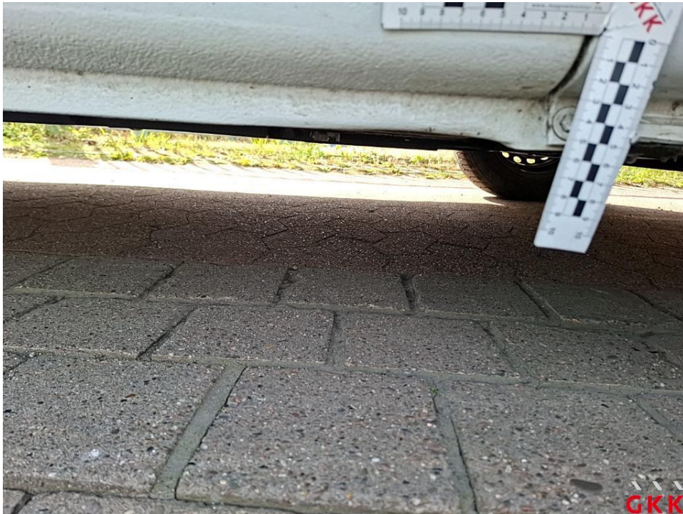
Bild 17. Schweller rechts, beschädigt, instand setzen - lackieren
