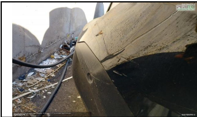
Foto daños externos 1
