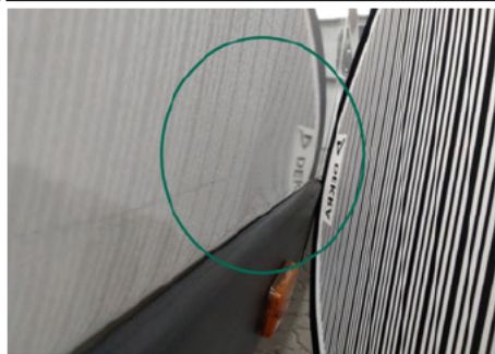
Seitenwand / Unten Hinten Rechts / Schlecht Repariert
