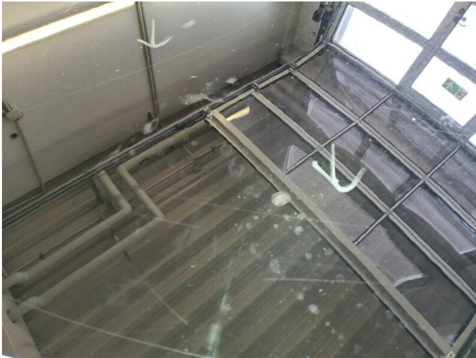
Bild 19 : Dach mehrere oberflächige Kratzer an diversen Stellen
