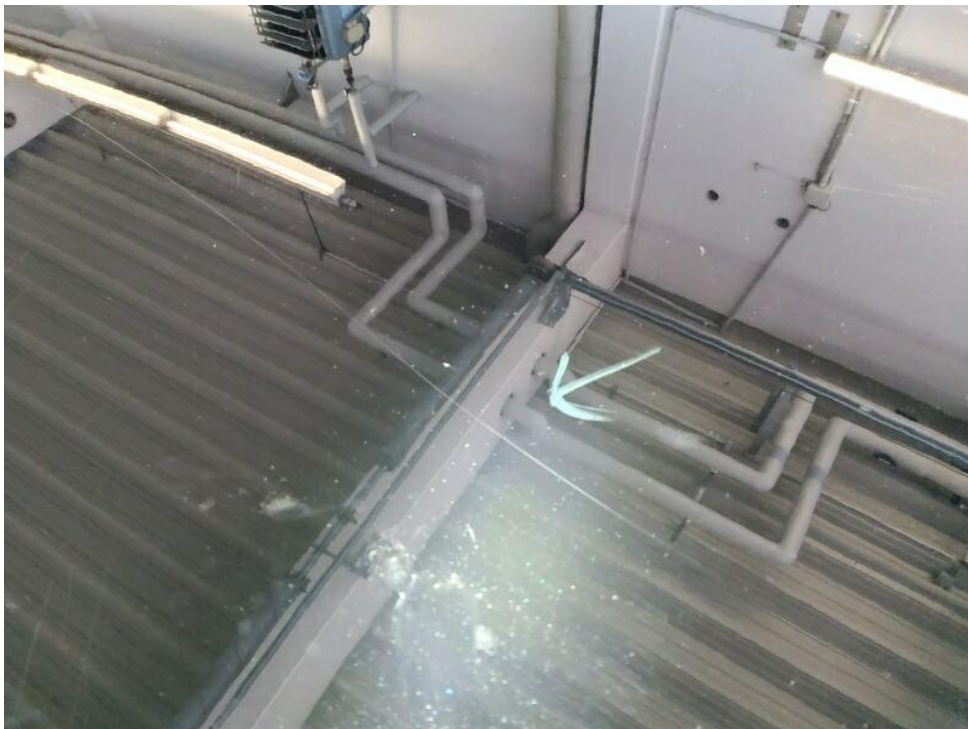
Bild 20 : Dach mehrere oberflächige Kratzer an diversen Stellen
