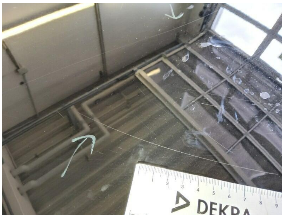
Bild 18 : Dach mehrere oberflächige Kratzer an diversen Stellen
