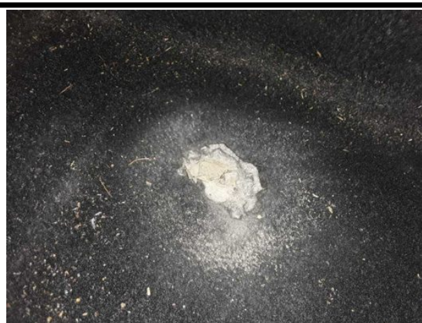
Beschädigung #8: Verkleidungen/Abdeckungen: Teppichboden vorn links - Löcher - erneuern
