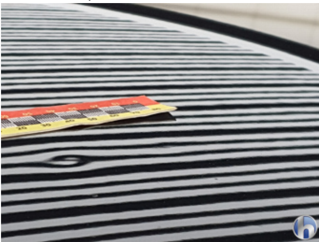
3. Dach 2 Dellen - Sanft Instandsetzen
