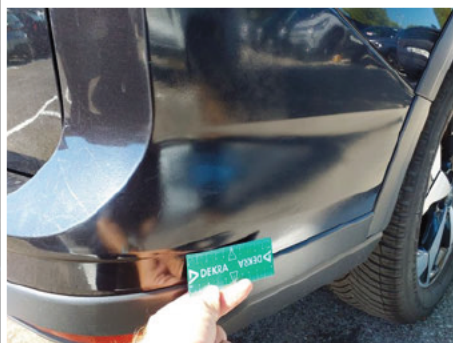
Pare-chocs / Arrière / Malfaçon
