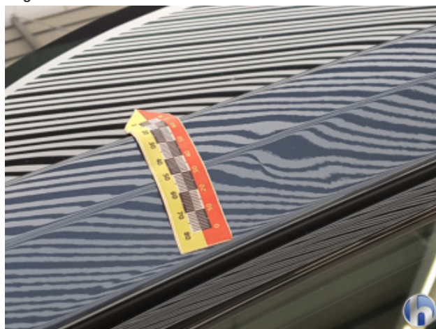
4. Dach Hagelschaden - Sanft Instandsetzen
