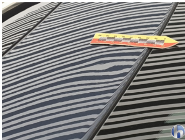
4. Dach Hagelschaden - Sanft Instandsetzen
