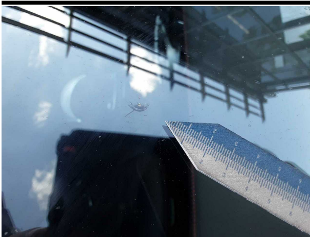
Beschädigung #11: Verglasung: Frontscheibe (Mit Rissbildung) - Steinschlag - erneuern
