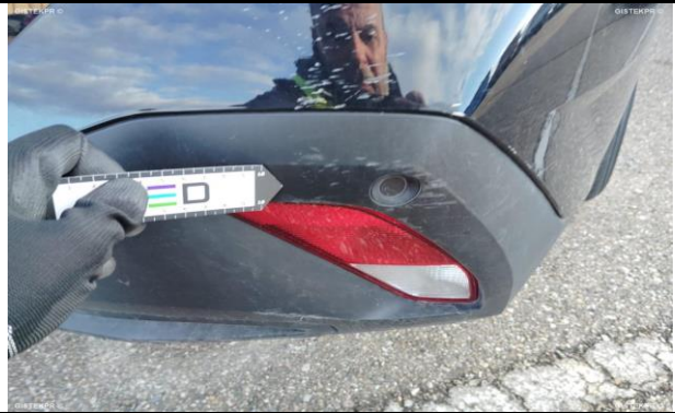
Foto daños externos 1
