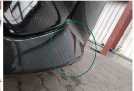
Stoßfänger / Vorne / Delle
