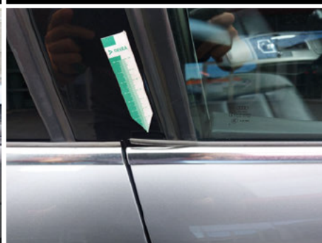
Fensterschachtabdichtung / Vorne Rechts / Defekt
