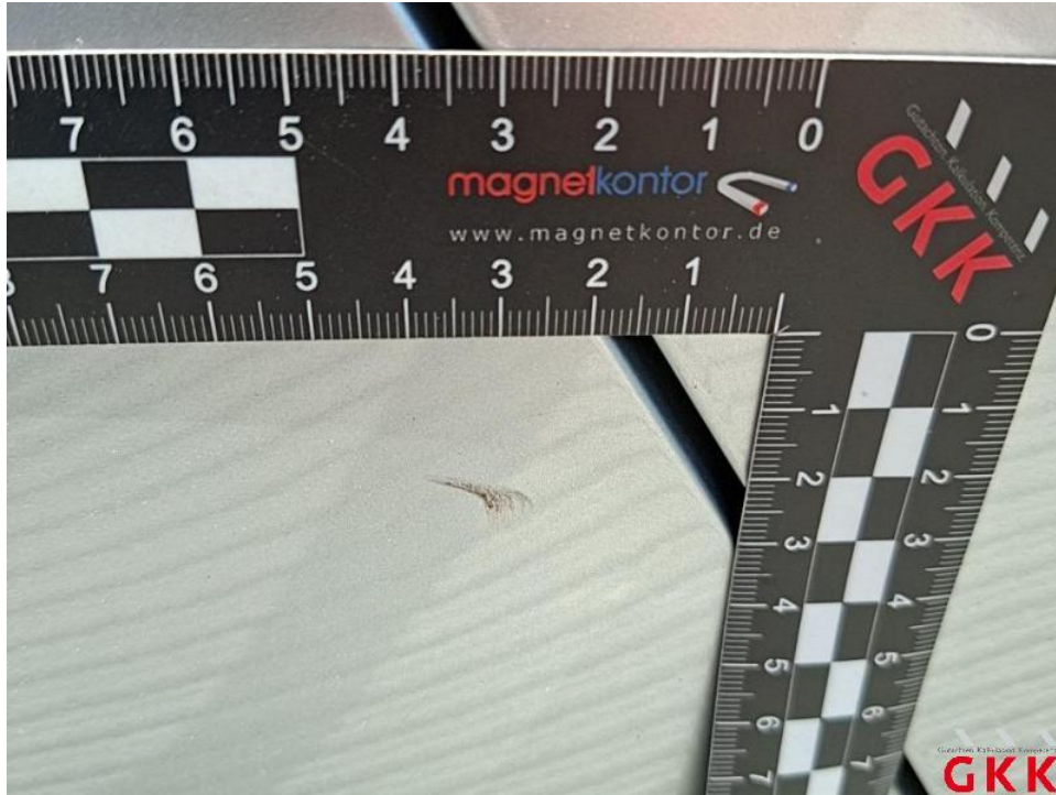
Bild 67. Seitenwand rechts, beschädigt, instand setzen - lackieren
