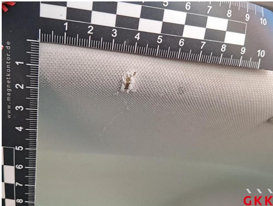
Bild 25. Himmel, beschädigt, ersetzen
