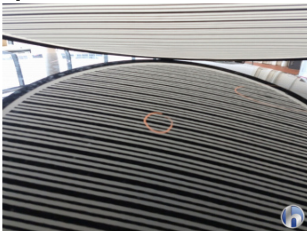
3. Dach Hagelschaden - Siehe Kalkulation
