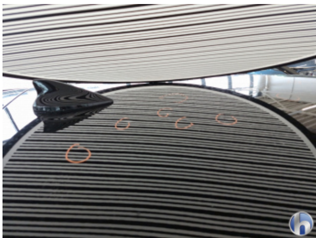
3. Dach Hagelschaden - Siehe Kalkulation
