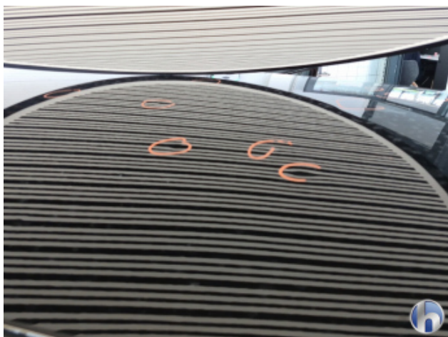
3. Dach Hagelschaden - Siehe Kalkulation
