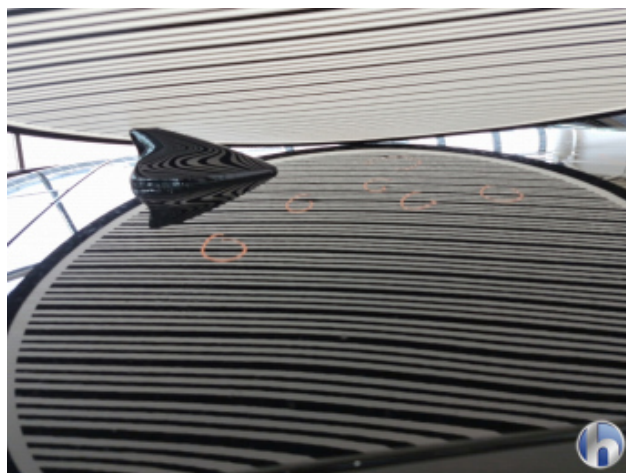
3. Dach Hagelschaden - Siehe Kalkulation
