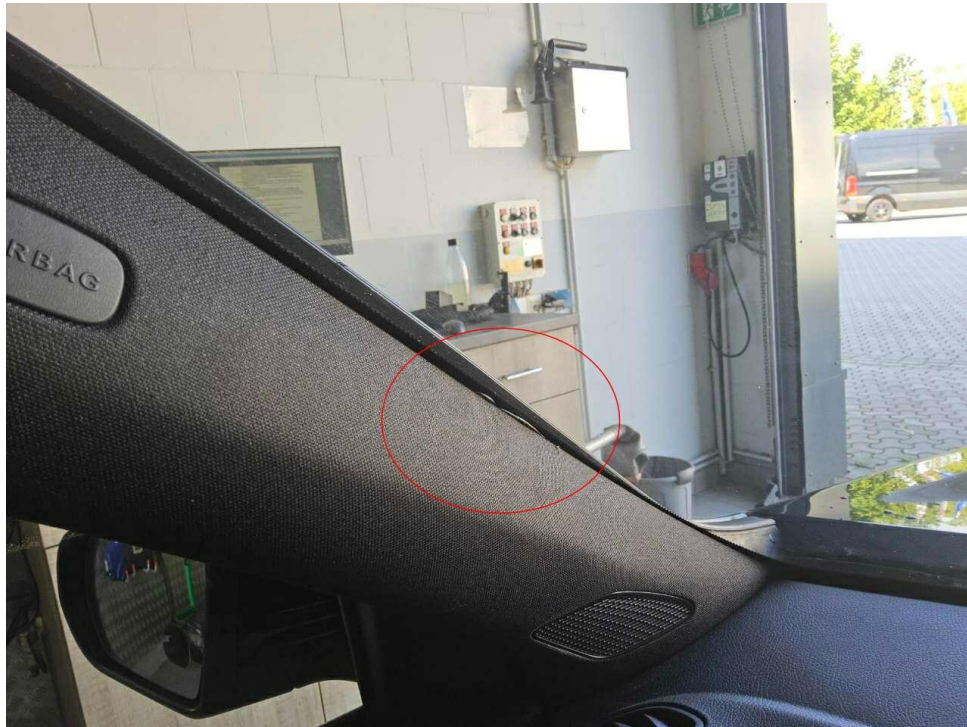
Bild 47 : Windschutzscheibe, ausgehärteter Kleber drückt sich an A-Säuleverkleidung links raus
