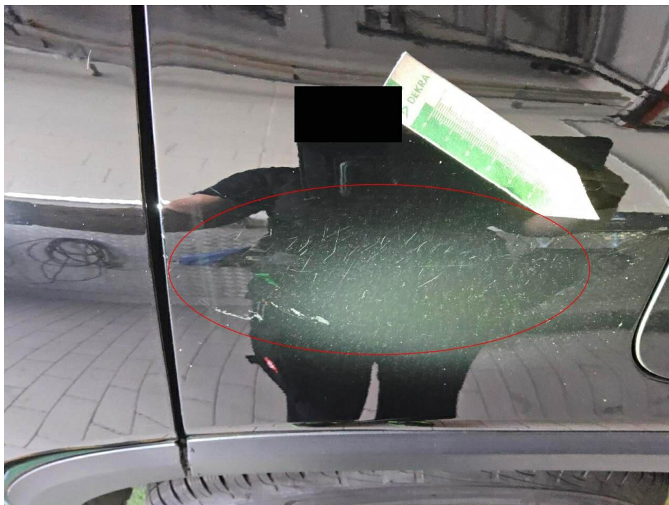
Bild 29 : Seitenteil hinten links Lackierung zerkratzt
