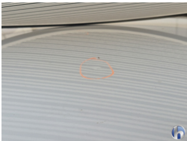
1. Dach Dellen / Beulen - Sanft Instandsetzen
