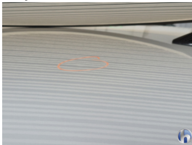
1. Dach Dellen / Beulen - Sanft Instandsetzen
