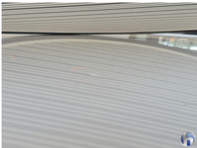
1. Dach Dellen / Beulen - Sanft Instandsetzen
