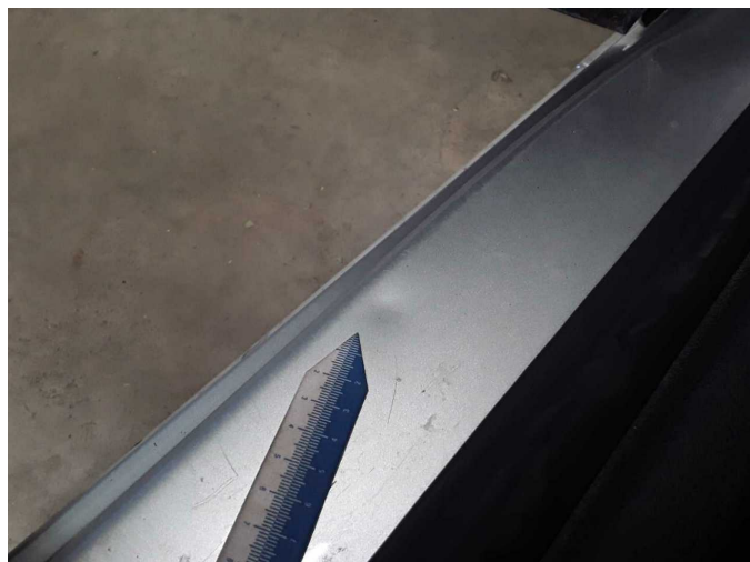
Damage 4: Sill - left side: Sill (Einstieg vorn rechts + Kratzer) - dent(s) - Repair and paint
