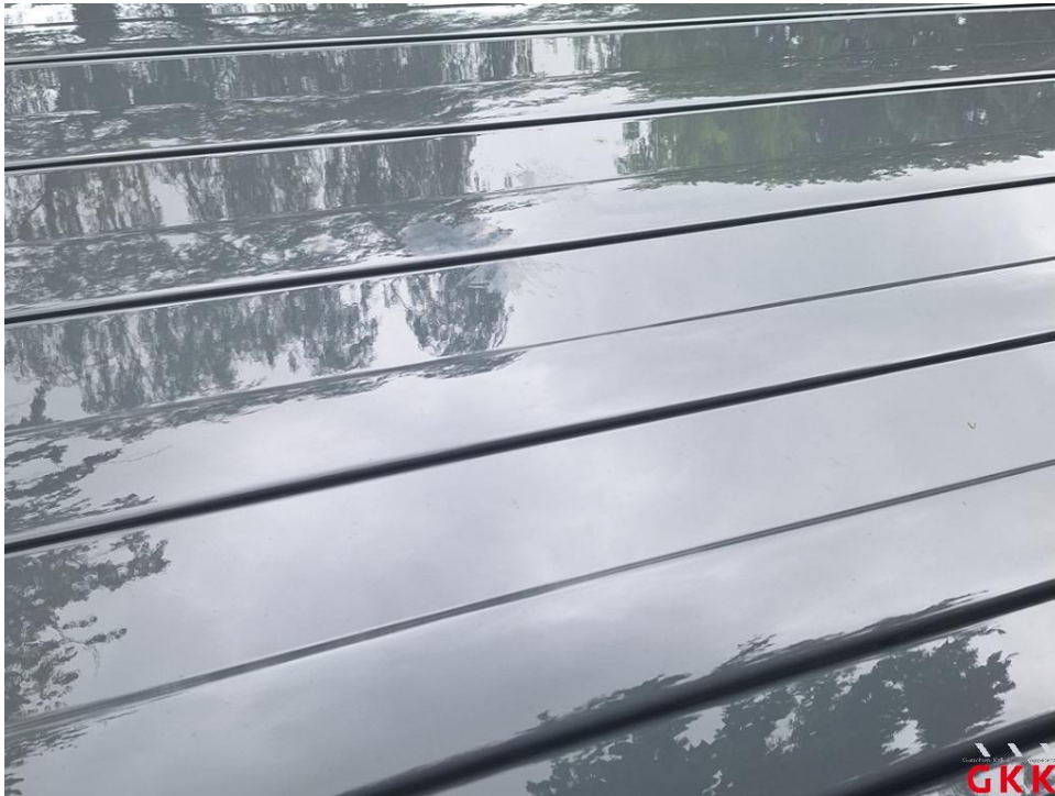
Bild 32. Dach, Lackierung verätzt, aufbereiten
