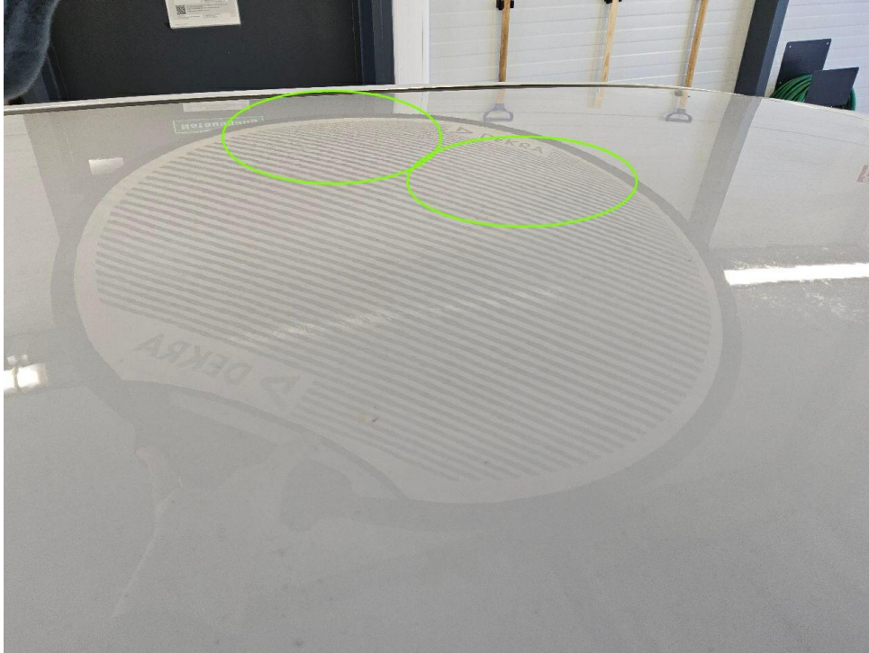
Bild 13 : Dach, Restspuren aus Instandsetzung, noch Dellen vorhanden
