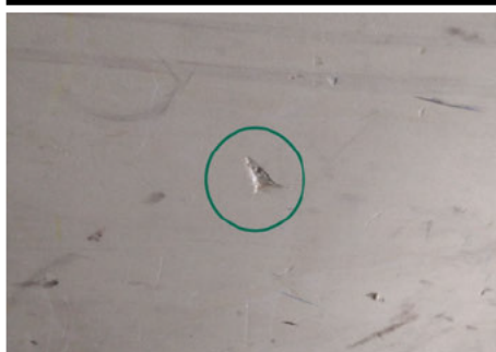
Innenverkleidung Laderaum / Rechts / Gebrochen
