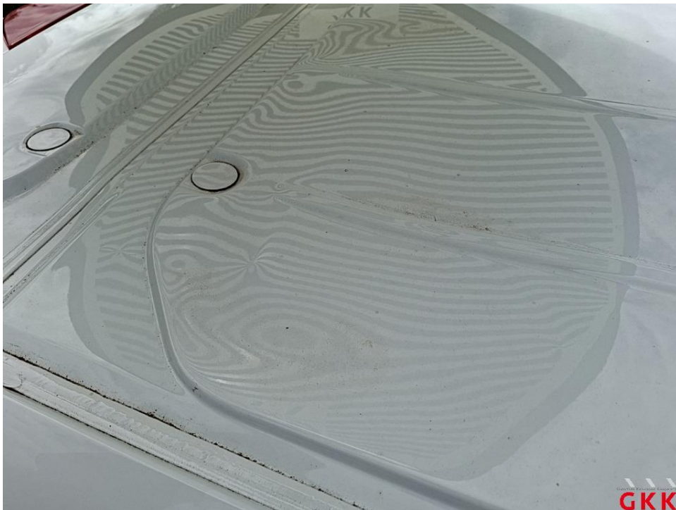
Bild 18 Dach, hinten, beschädigt, instand setzen - lackieren
