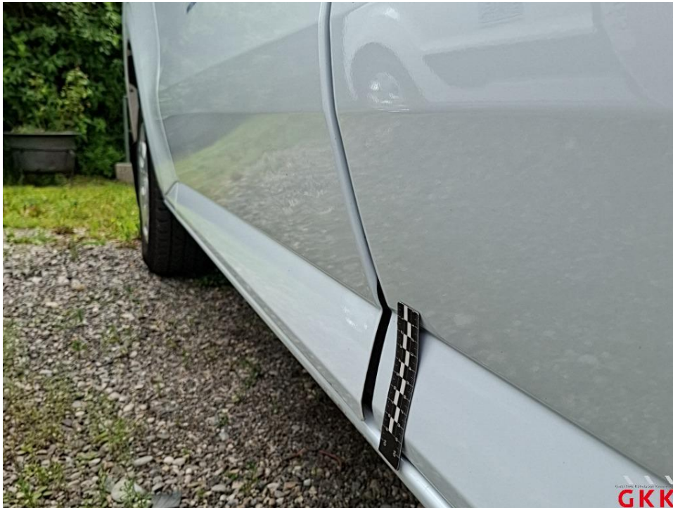
Bild 33 Schiebetür rechts, Spaltmaß fehlerhaft, instand setzen
