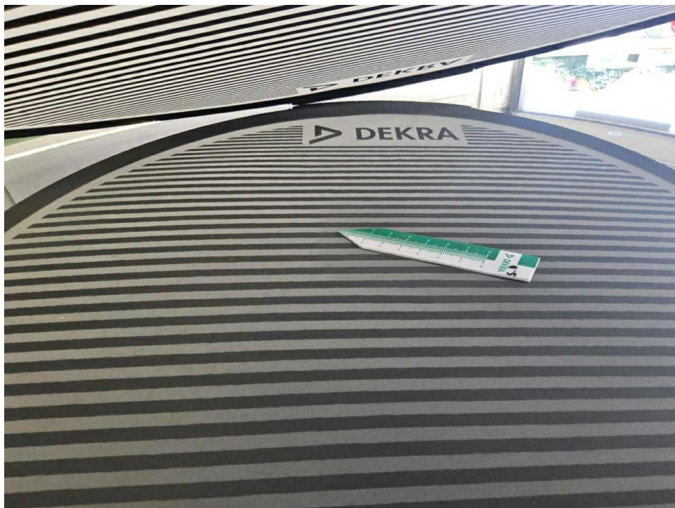
Bild 18 : Dach, eingedellt, Gebrauchsspur
