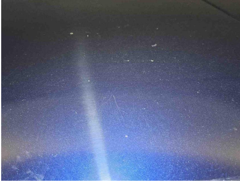
Kratzer auf dem Dach
