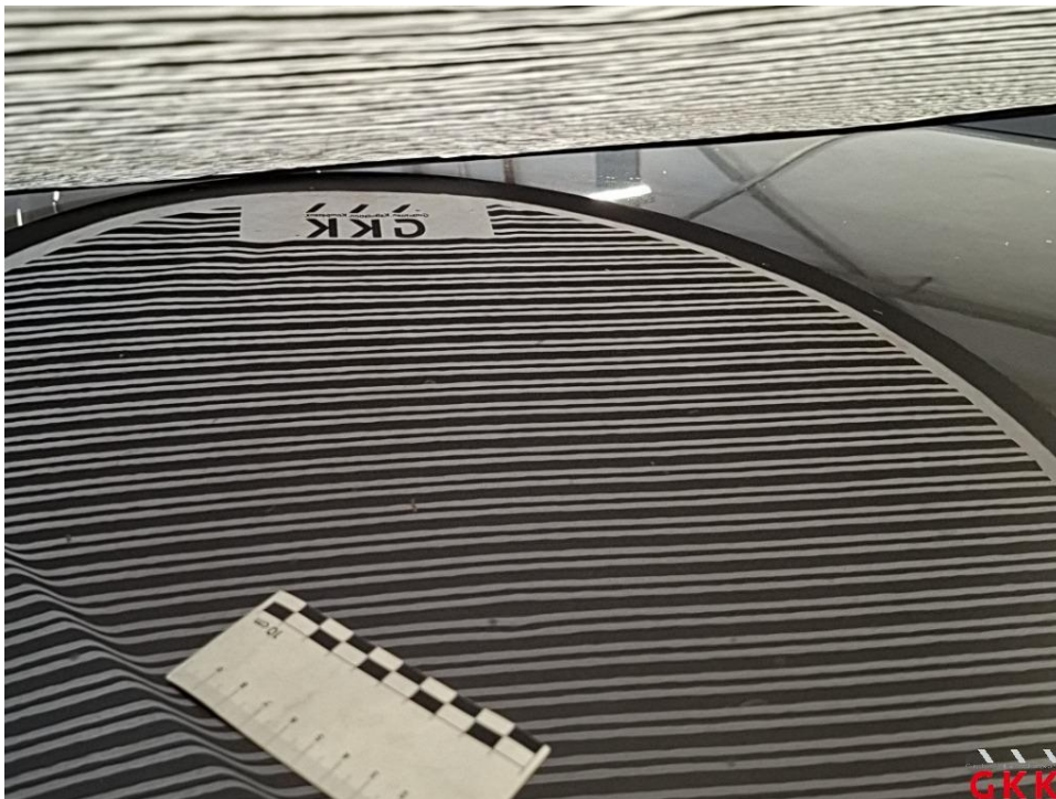
Bild 32 Dach, beschädigt, kalt drücken
