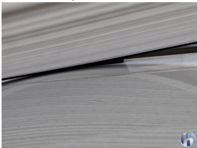
3. Dach 1 Delle - Sanft Instandsetzen
