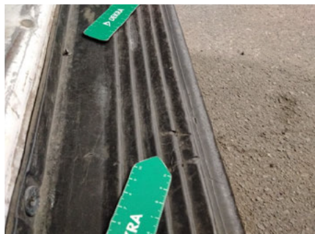
Stoßfänger / Hinten / Gebrochen
