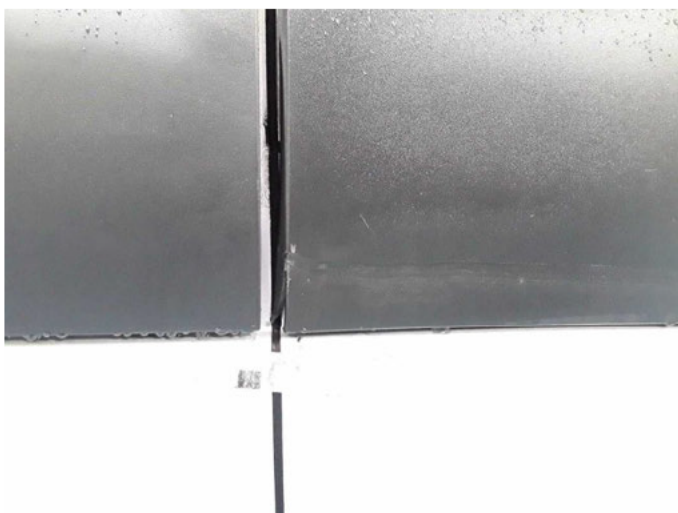
Beschädigung 4: Seitenwand links: Schutzleiste - beschädigt - erneuern
