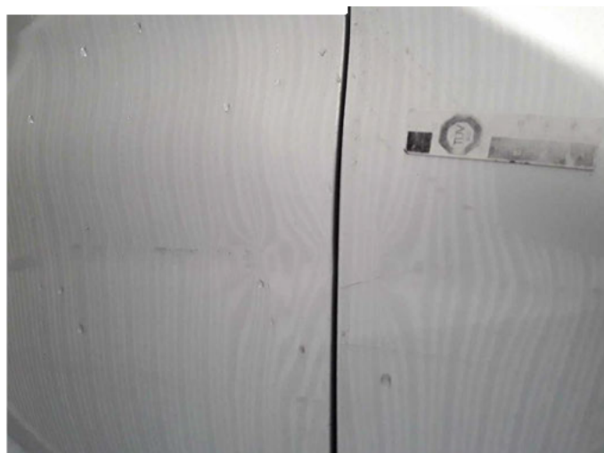
Beschädigung 48: Schiebetür rechts: Schiebetür - beschädigt - erneuern
