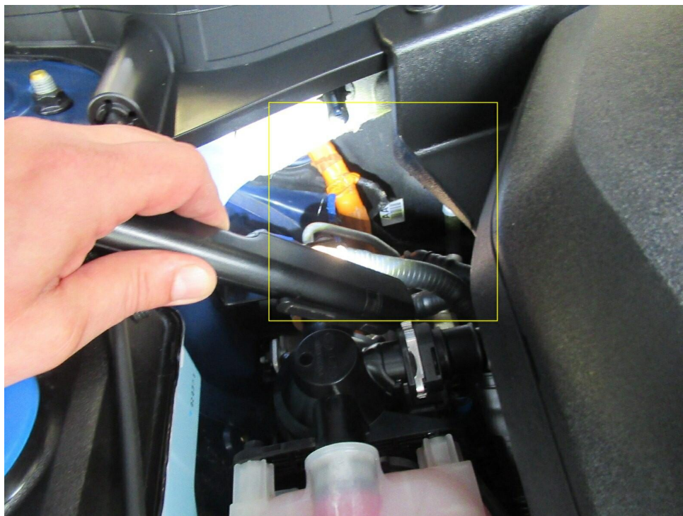
Bild 7 : Motorraum (Kabel) mit Tierversbiss, prüfen, Schadenerweiterung möglich
