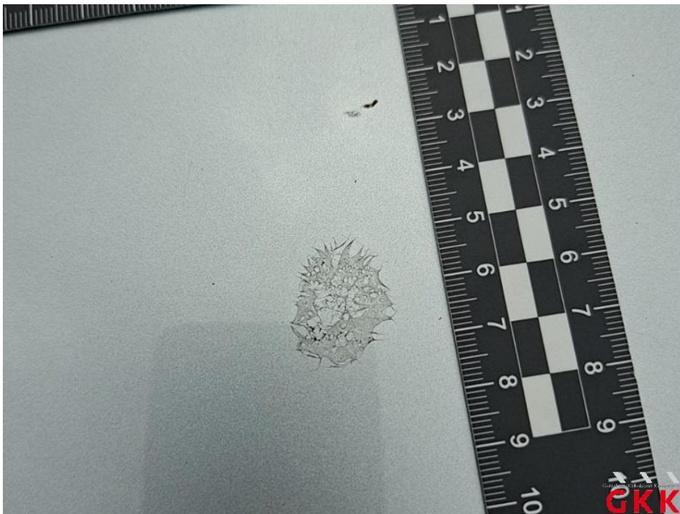
Bild 16. Dach, Lackierung abgeplatzt, lackieren
