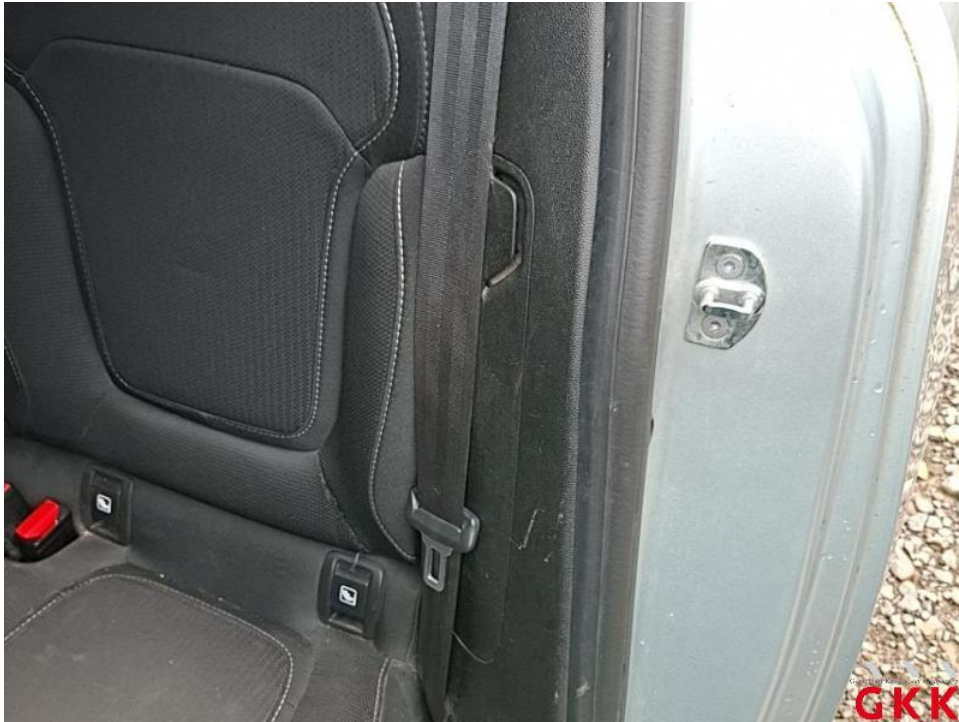
Bild 51. C- Säule links, Innenverkleidung -unterhalb-, beschädigt, ersetzen
