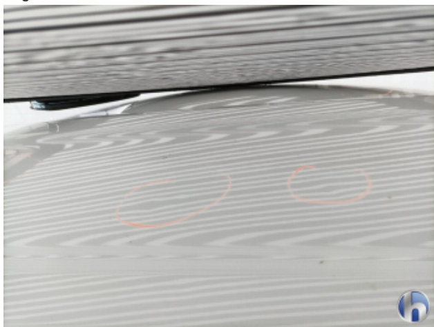
1. Dach Hagelschaden - Sanft Instandsetzen
