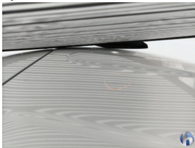
1. Dach Hagelschaden - Sanft Instandsetzen
