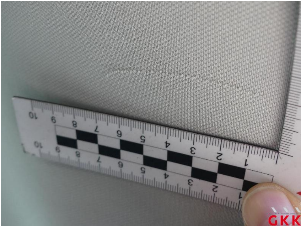
Bild 50. Himmel, hinten, beschädigt, Smartrepair
